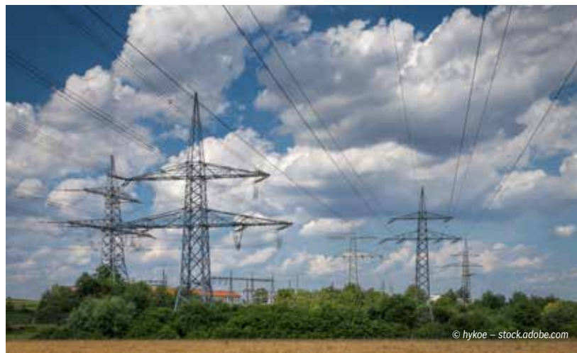
Schon 2008 forderte die Wirtschaftskammer eine sichere Energieversorgung durch den Bau der 380-kV-Leitung, die aufgrund vieler Widerstände erst 2025 in Vollbetrieb gehen konnte.
